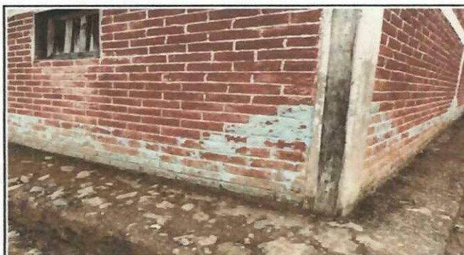
Foto 3: Se puede observar la parte de enfrente y superior del Centro Educativo se verifica que la pared se encuentra en mal estado.
