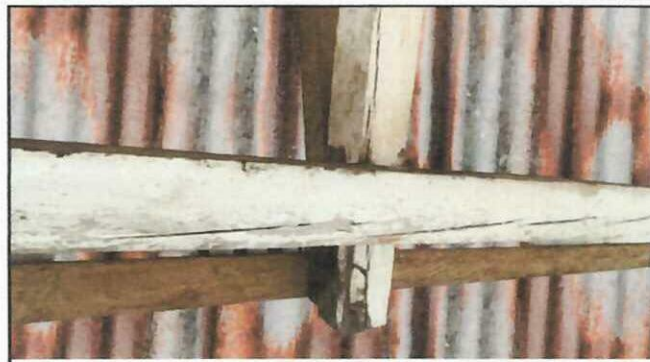
Foto 2: Se puede observar la parte de adentro del Centro Educativo se verifica que las vigas y láminas se encuentra en mal estado.
