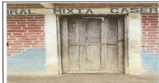
Foto 6: Se puede observar las puertas del Centro Educativo en mal estado.
