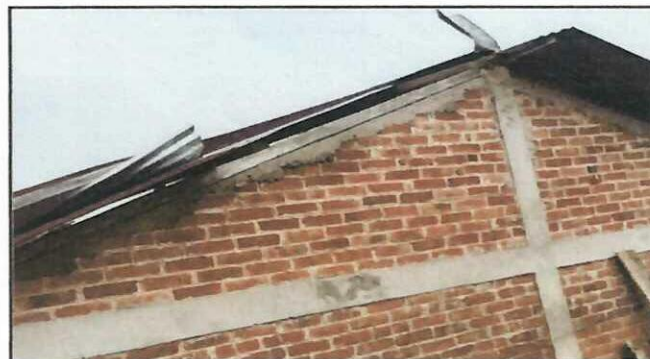
Foto 4: Se puede observar la parte superior del Centro Educativo se verifica el deterioro de las laminas y vigas de madera.
