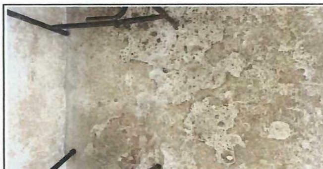
Foto 5: Se puede observar el deterioro del piso del centro educativo.
